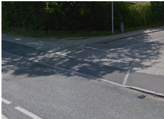
Frederiksborgvej/Prøvestensvej - Overkørsel med gennemgående flisefortov og cykelsti. Kantsten er sænket mod kørebanen.
